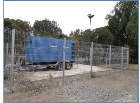
Generador de Catapilco, y Cierre Perimetral (Financiamiento Compartido)
