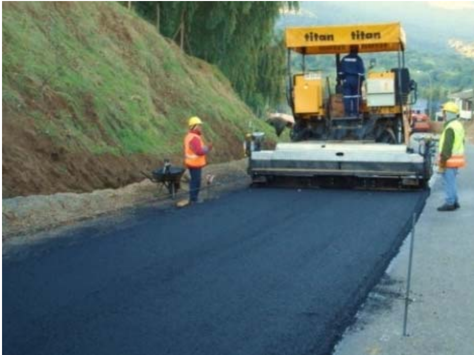
Trabajos de recarpeteo asfáltico realizado por la empresa Besalco en la ruta E-30-F
