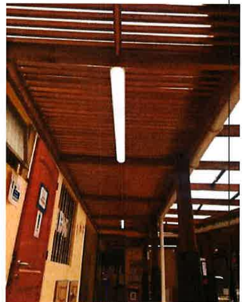
Imagen N°2: Iluminación LED pasillos
