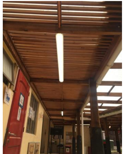
Imagen N°2: Iluminación LED pasillos
