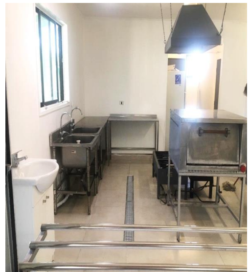
Imagen N°4: Cocina Escuela Aurelio Duran
