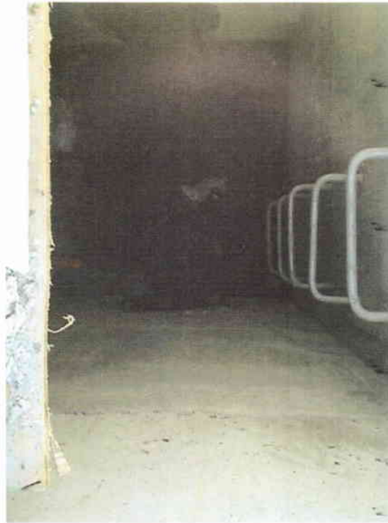
Figura 4: Estado actual de cámaras de colector aguas lluvias
