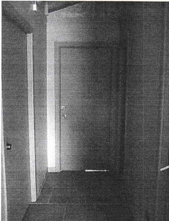
Foto 9.- Falta de demarcación de vías de escape y discapacitados.
