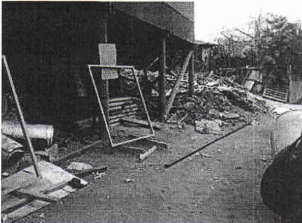
Foto 25.- Escombros y basura en obra, sin estar protegidas al paso de terceros.
