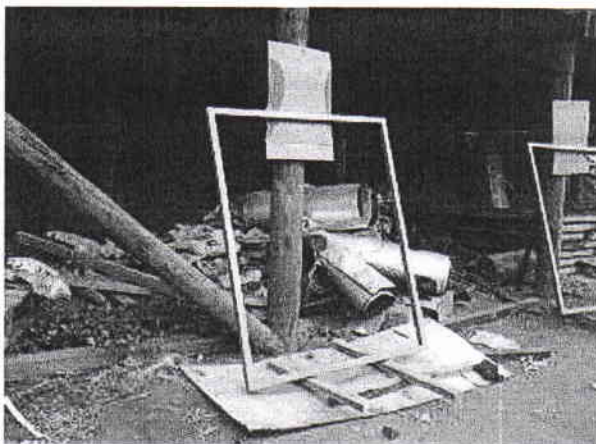
Foto 26.- Escombros y basura en obra, sin estar protegidas al paso de terceros.
