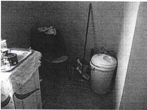
Foto 11.-No se instaló el lavaplatos, el cual estaba considerado en planos de arquitectura, sin embargo no en el presupuesto detallado presentado por el oferente.
