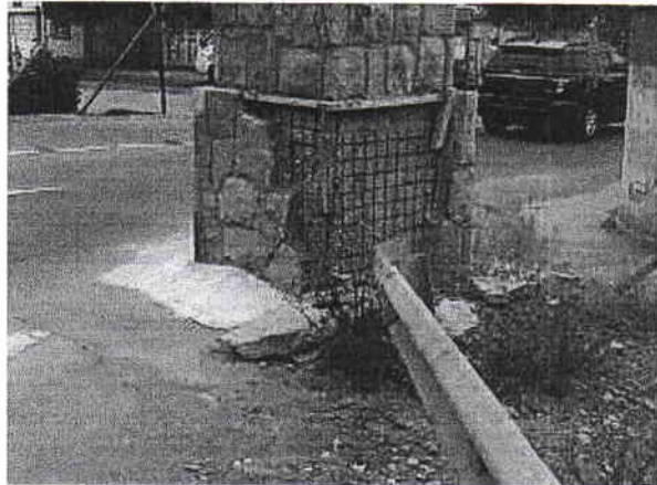
Foto 2.- Estado actual del portal de acceso a Laguna de Zapallar, la mampostería presenta alto grado de deterioro.
