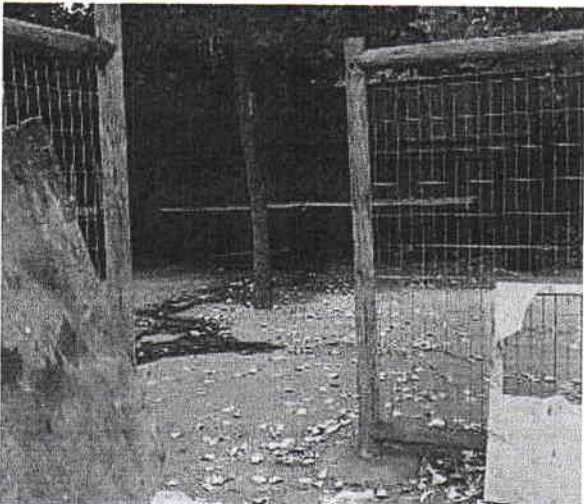
Foto 14.- Obras sin terminar sin protecciones.
