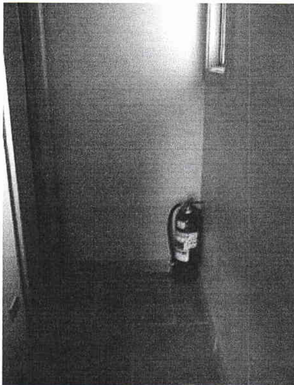
Foto 10.- Falta de demarcación ubicación de extintores.
