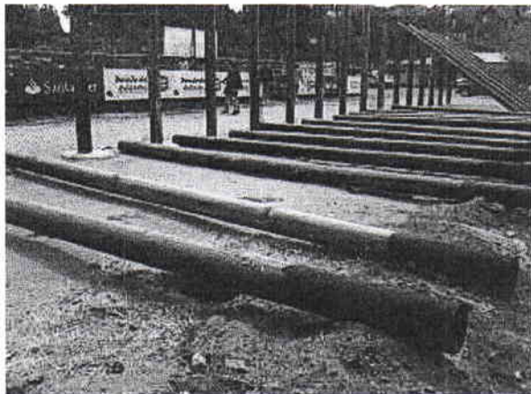
Foto 20.- Graderías nuevas ubicadas al costado de las originales, ya que no fue considerada la demolición de las originales. Sólo esta parte de las obras cuenta con protecciones.
